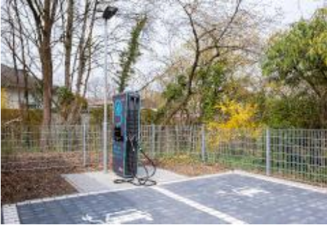
Ladesäule Dreiherrnsteinplatz © Stadtwerke
