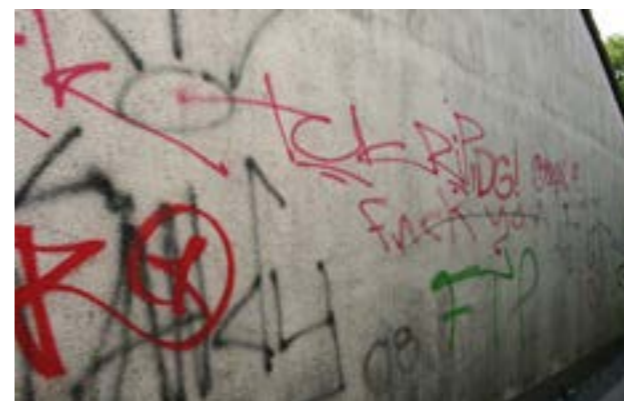
Abb. 18: Vandalismus durch Graffiti, Quelle: ProjektStadt 2018
